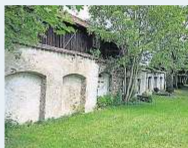
Mauer: Kosten rund 1000 000 Euro – der aufwendigste Teil ist der mit den Nischen für Gräber.
