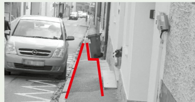
Hier hilft nur noch die Generalsanierung und Neugestaltung.
