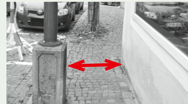
Schmale Gehwege, große Steinsockel der Straßenlaternen engen die Gehwege ein.
