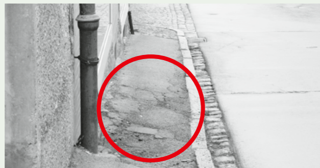
Kaputte und enge Gehwege säumen die Autopiste.
